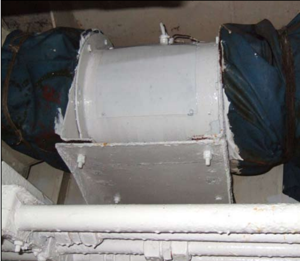
Forward store ventilation fan
