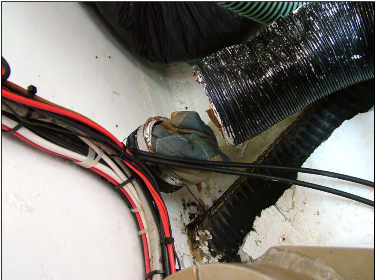
Sheared air conduit
